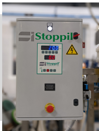
Armoire de contrôle
